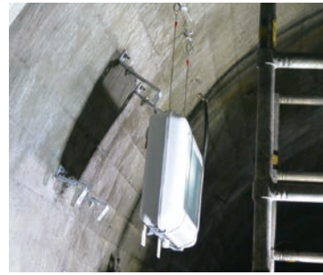
落下防止状況
